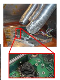
電子制御装置:抵抗破損を確認(フィールド障害の再現)
